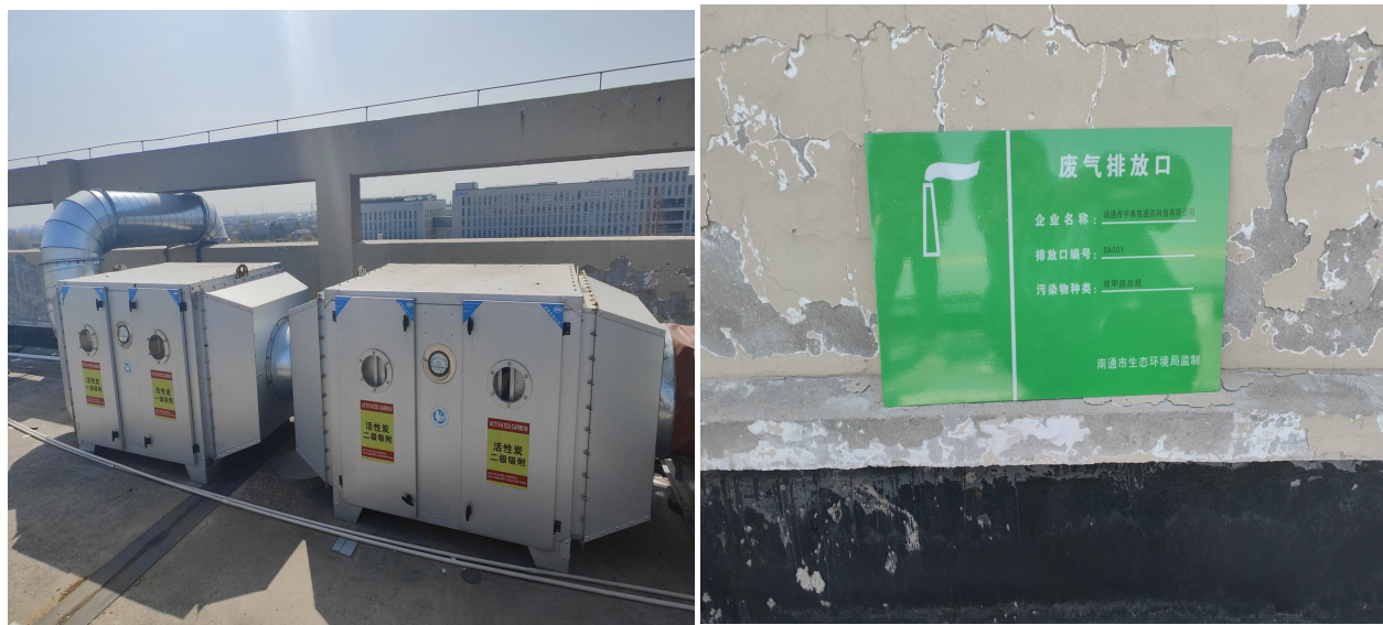
图 3-3 废气治理设施及标识标牌
